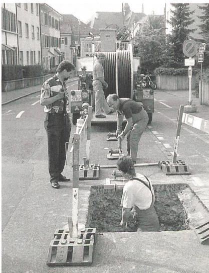
Le maître électricien de réseau (à g.) contrôle les travaux. Le délai d'inscription au prochain cours de préparation à l'examen de maîtrise est le 1 er mars 99.
