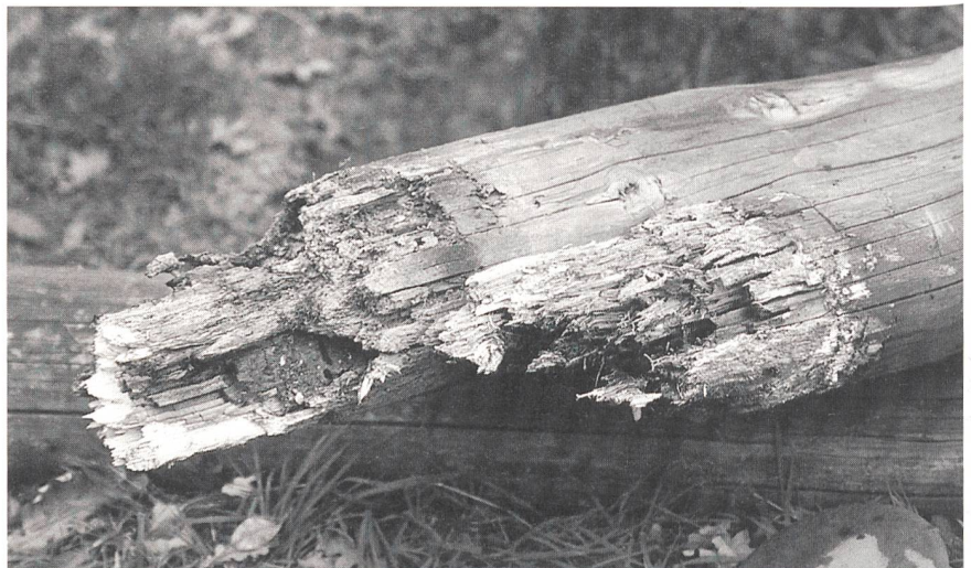
Moder- und Weissfäulepilze als Schadenursache.
