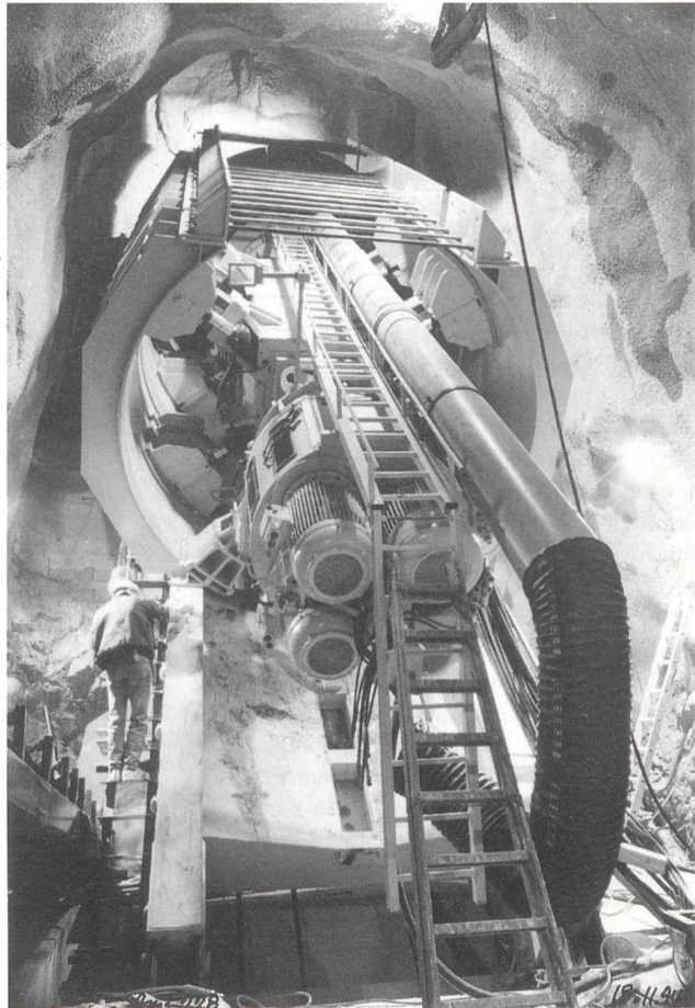
Bild 6 Startt re f r die Druckschachtfr se. Der Schacht ist 382 m lang und hat 85% Gef lle (Photo P. Mainardi).
