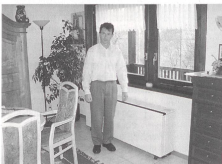
Dieser Hauseigentümer hat sich für eine Heizkörper-Wärmepumpe entschieden. Die Hälfte der Heizenergie erhält er gratis aus der Luft (Bild Hegner Energiesysteme AG).
