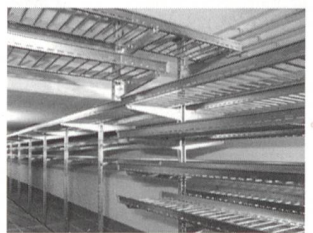
Kabelführungen aus rostfreiem V 4 A-Stahl
