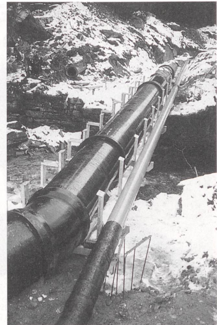
Bild 6 Wie hier bei der ungedeckten Rohrbrücke sichtbar, wurde neben der Kraftwerksdruckleitung noch eine Hochdruckleitung für die Beschneigungsanlage verlegt.
