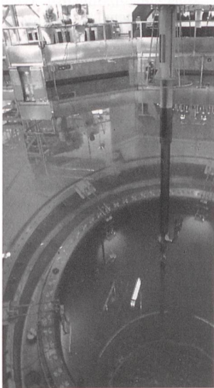
In Schweden werden die Brennstäbe weiterhin aufgefüllt (hier der Reaktor des KKW Forsmark 3).
