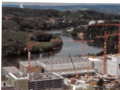
Entsorgung radioaktiver Abfälle: der Bau des zentralen Zwischen- lagers in Würenlingen (AG) schreitet planmässig voran.
