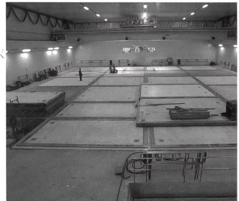
In dieser Lagerhalle werden Abfallgebinde mit mittelaktiven Abfällen zwischengelagert. Die Lagerschächte werden mit Betonplatten verschlossen.
