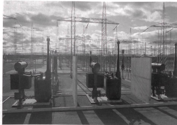
Milliardenschäden auf nördlichen Stromnetzen? (800-kV-Unterwerk in Kanada).
