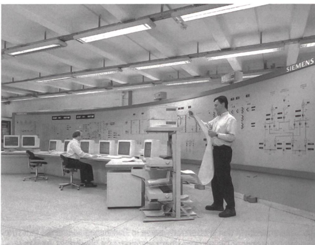
Bild 3 Schaltwand der Station Tianshengqiao
