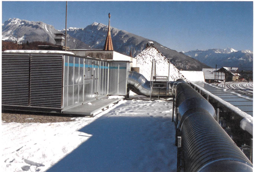
Bild 2 Lüftungsmonobloc / Wärmepumpe / Wärmerückgewinnung mit Luftansaugkanälen aus den Pufferzonen
