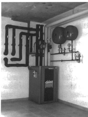
Wärmepumpe in Minergiehaus
