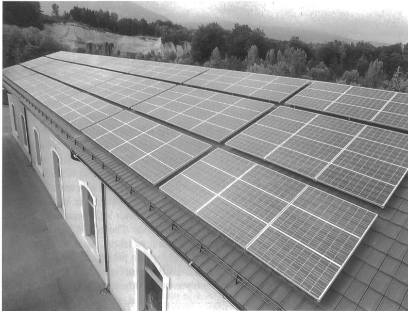
Die Solaranlage auf dem Dach des 100jährigen Turbinenhauses der AEK Energie AG produziert im Jahr etwa 26 000 kWh Solarstrom. Mit dem Verkaufserlös speisen die vier Partner AEK Energie AG, Städtische Werke Solothurn, Städtische Werke Grenchen und Energie Service Biel/Bienne einen Ökofonds zur Förderung erneuerbarer Energien.
