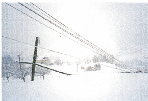
Sturmschäden auch in der Zentralschweiz (Bild CKW).
