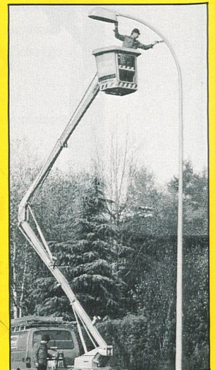
Korrosionsschutz an Stahlkandelabern
