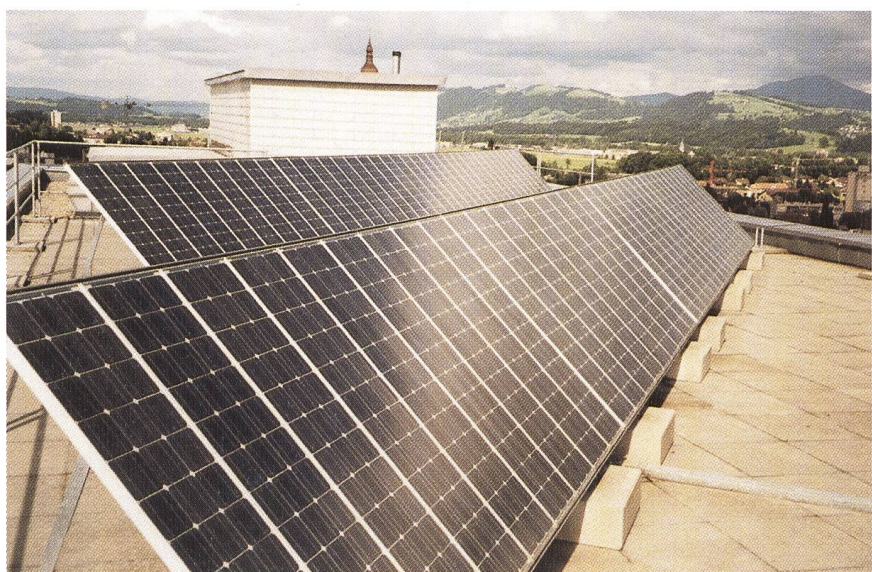
Bild 1 Photovoltaikanlage Alp Emmen, Aufständerung.
