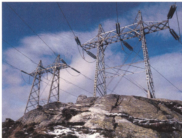
Probleme mit den Netzen in Skandinavien: Hochspannungsleitung in Norwegen.
