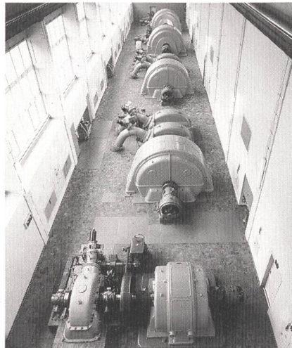
Heutiger Maschinensaal im EW Schwanden. (Bild: SN Energie)
