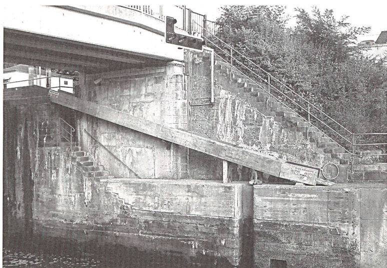
Bilder: T. Zeier, Kraftwerk Augst.
