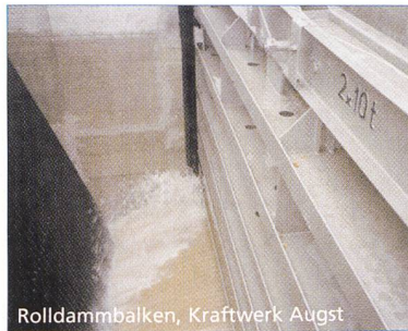
Rolldammbalken, Kraftwerk Augst
