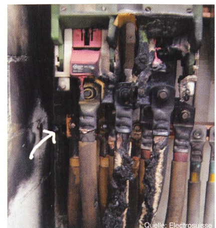
Bild 6 Ansicht des Unfallorts
