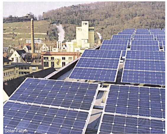
Cellules photovoltaïques de Solar-Fabrik pour la brasserie Ganter à Freiburg im Breisgau
