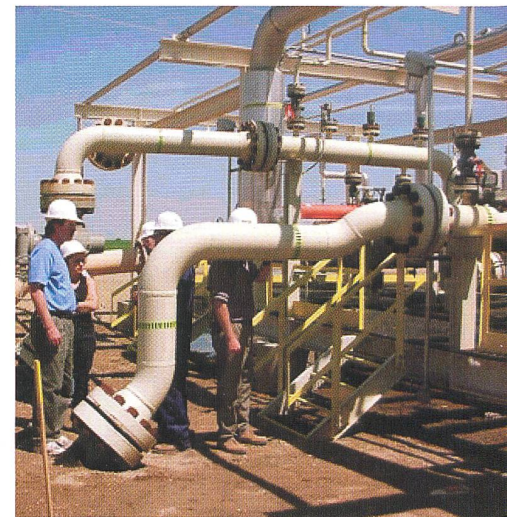
Pipeline CO 2 entrant à Weyburn.
