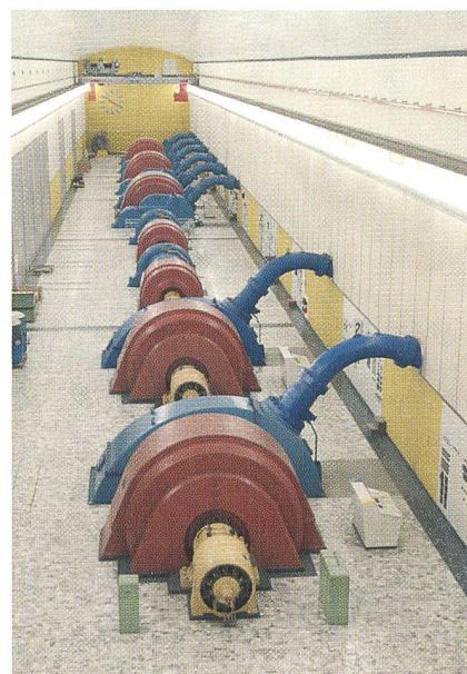
Hochdruck-Peltonturbinen im Kavernenkraftwerk Tierfehd mit leittechnischen Ausrüstungen von Rittmeyer
