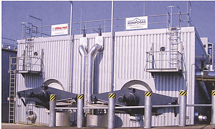
Fermenter mit Förderantrieb für Biomasse.
