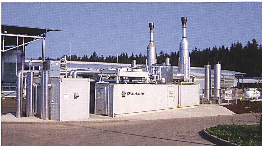
Blockheizkraftwerk mit zwei Gasmotoren/Generatoreinheiten.
