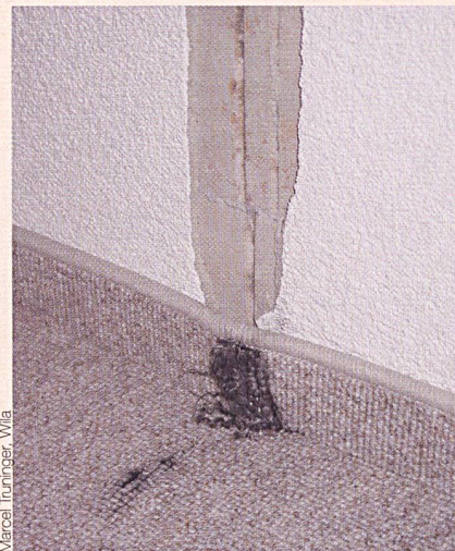
Ergebnis eines Blitzschlags durch eine Giebfassade, entstanden durch die Firstpfettenbefestigung mit einem Metallband auf die Betondecke; daher der Austritt des Blitzes über dem Boden.
