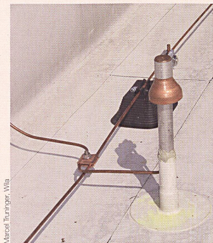
Flachdachdurchführung. Die Verbindung zur Betonarmierung verhindert den Durchschlag infolge hoher Potenzialunterschiede.
