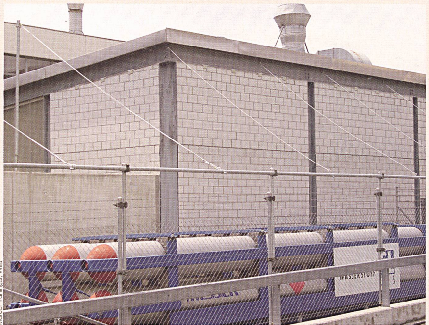
Spezielle Blitzschutzanlage über einem Wasserstofftanklager mit gespannten Fangleitungen.
