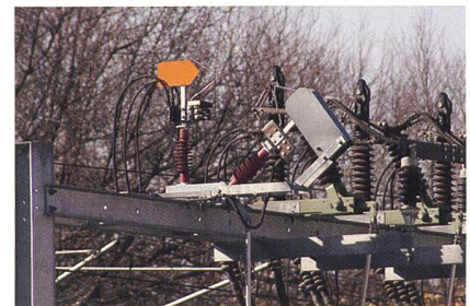
Erdungsschalter im Sternpunkt. Disjoncteur shunt en neutre.
