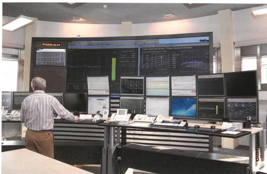
Arbeitsplätze des operativen Kraftwerkeinsatzes mit Grossbildprojektion.
