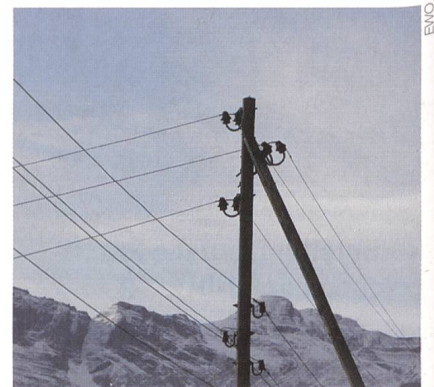
Mittelspannungs-Verteilnetz des EW Obwalden
