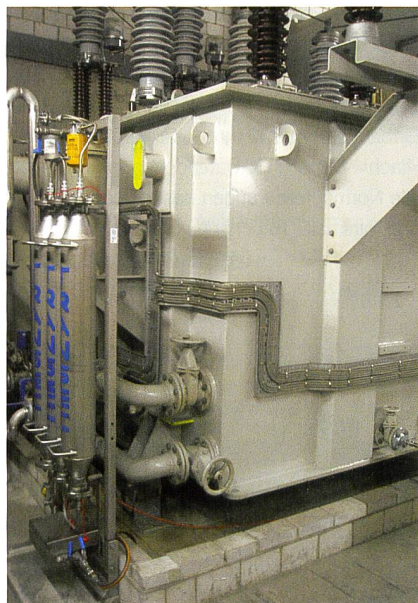
Mit stetiger Trocknung leben Trafos länger.
