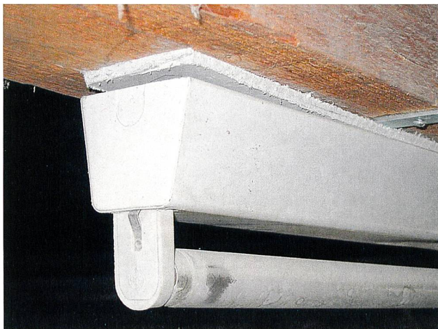
Asbesthaltige Leichtbauplatte unter FL-Armatur (schwach gebundener Asbest).
