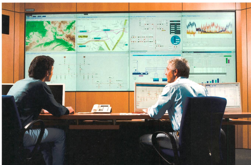
Figure 3 Des systèmes SCADA modernes sont essentiels à la sécurité de l'approvisionnement électrique.
