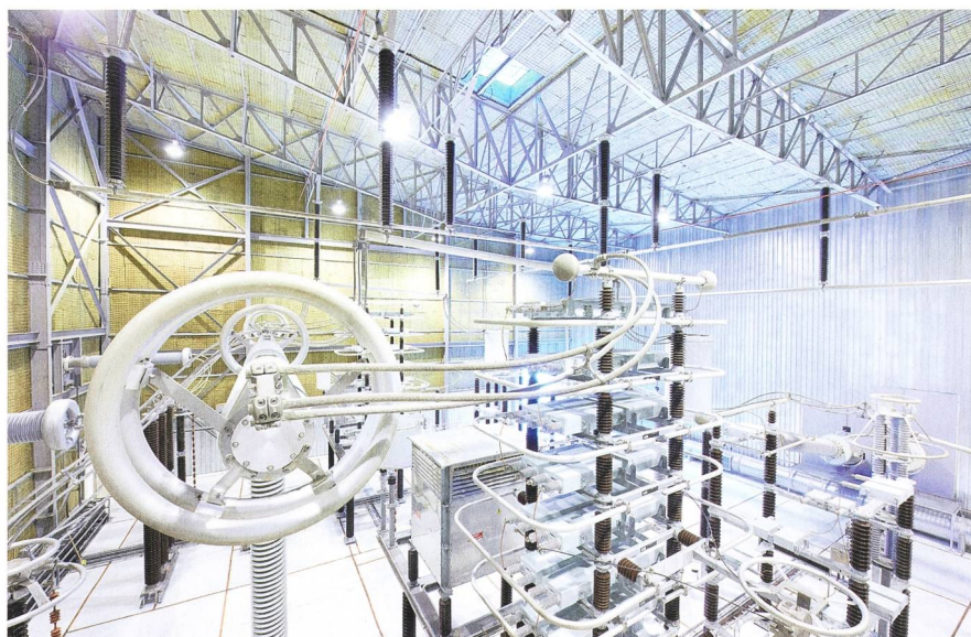
Eine HGÜ-Umrichterstation von ABB.
