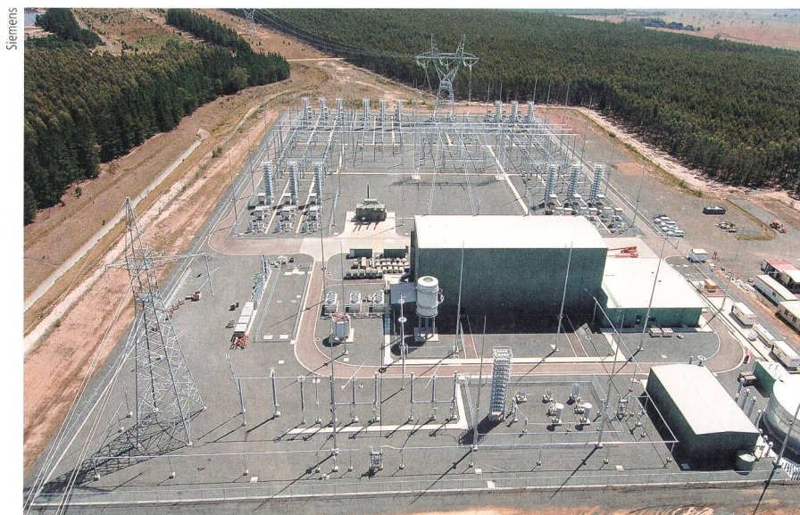
Konverterstation eines vergleichbaren Projektes in Australien.
