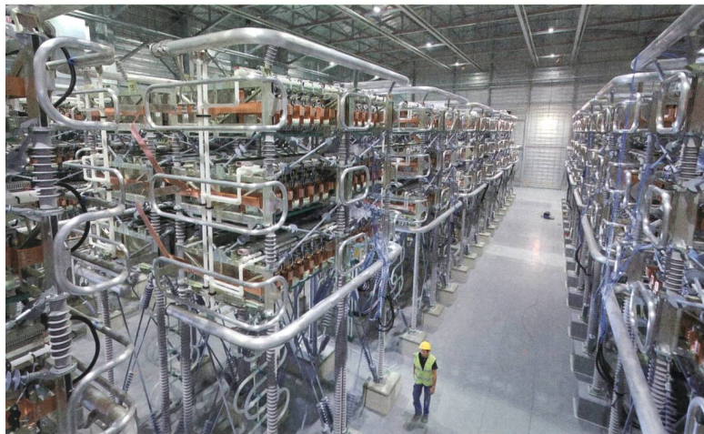
Die HVDC-Plus-Technik basiert auf selbstgeführten Stromrichtern (VSC) in modularer Multilevel-Converter-Bauweise (MMC), die den Wechselstrom in Gleichstrom – und umgekehrt – wandelt.
