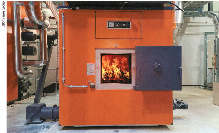
Einer der zwei Kessel der neuen Holzsnitzelheizung.
