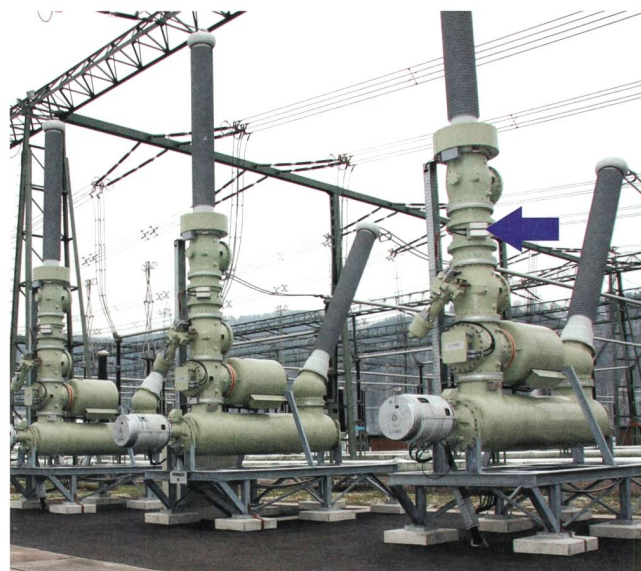
Bild 5 Beispiel einer Installation mit NCIT. Der Pfeil zeigt auf den Sensor, der die Abtastwerte an den Zähler und die Schutzeinrichtung sendet.
