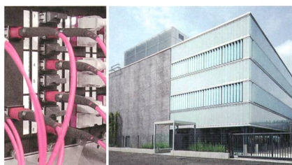
Dans les racks ont été installés env. 3000 tiroirs de modules FO-DCS avec six LC-Quads chacun.
