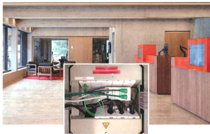
In Ilanz nutzt die Raiffeisenbank Surselva ein Kommunikationsnetz von Dätwyler.
