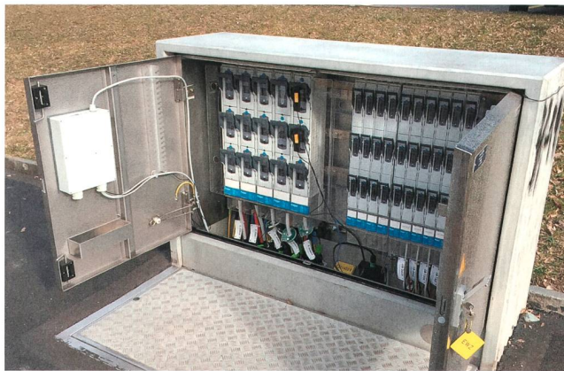
Bild 3 Beispiel einer Installation in einer Verteilkabine.
