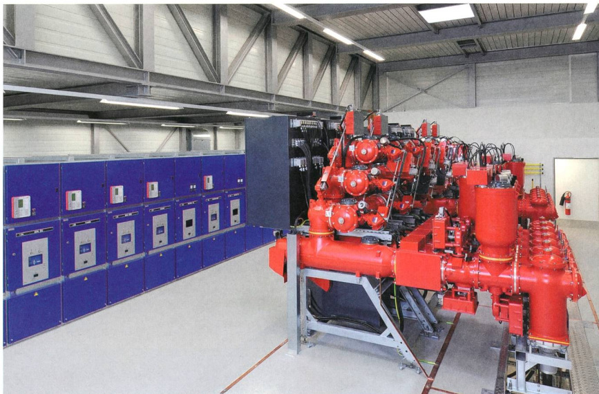
Bild 2 Ferngesteuerte Schaltanlagen des Unterwerks Rafz.
