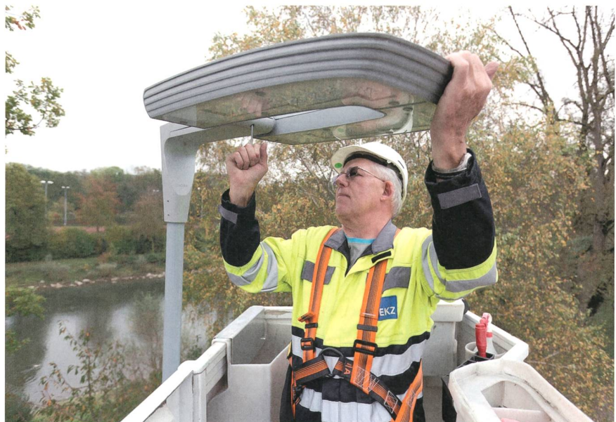
LED-Strassenleuchten sind an sich schon energieeffizient. Werden sie verkehrsabhängig gesteuert, erhöht sich die Effizienz noch.
