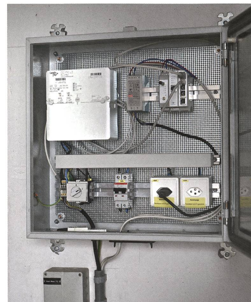
Der Datenkonzentrator sammelt die Zählerdaten und leitet sie weiter an das Rechenzentrum.
