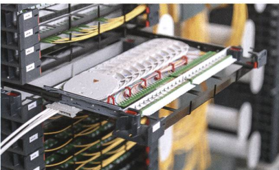
Neue Einschübe für das Fasermanagement.
