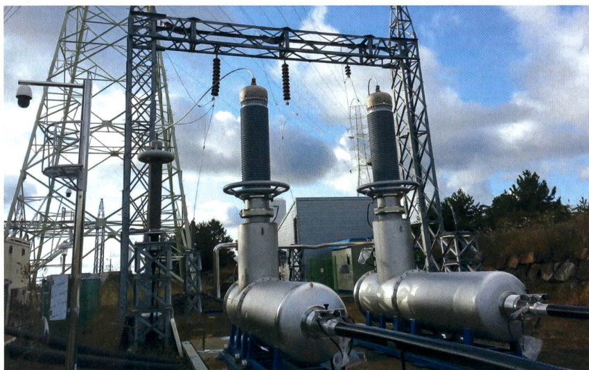
Extrémité d'un câble supraconducteur à courant continu avec une tension de 80 kV en Corée du Sud.
