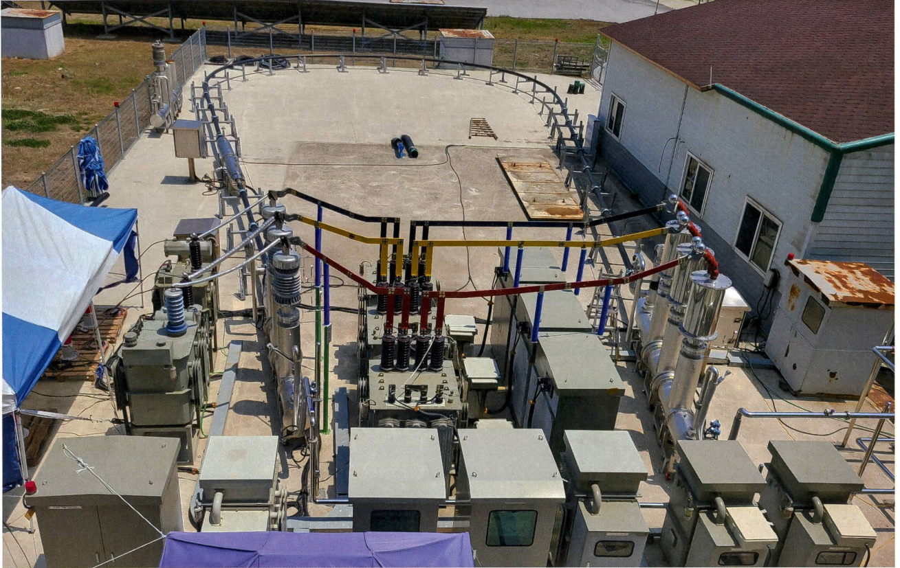
Test d'un câble HTS (23 kV, 60 MVA) dans le district de Gochang, en Corée du Sud.
