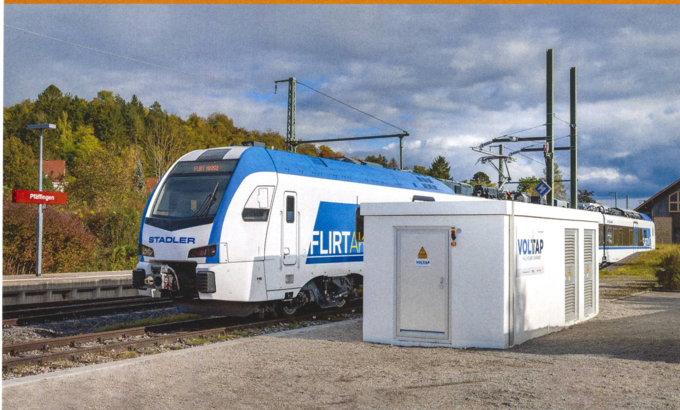
Prototyp der Voltap-Schnellladestation für Batteriezüge.
