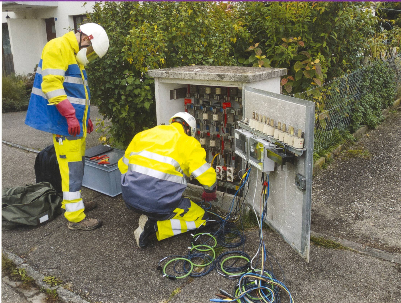
Installation der PQ-Messgeräte in einer Verteilkabine.
