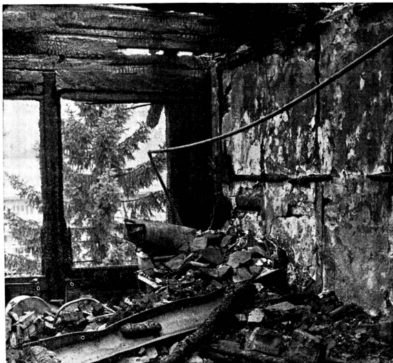
Wenn Gasolin oder Benzin in einem geschlossenen Raum verdampft, wenn Leuchtgas aus einem Herd oder Badofen austritt, entsteht ein hochexplosives Gas-Luft-Gemisch. Der kleinste Funken kann die Explosion auslösen. Und was einmal eine Küche, ein Badzimmer war, das sieht dann so aus... Darum: auf Gasherde, Badöfen, auf Benzin und Gasolin ganz besonders gut aufpassen! BfB
