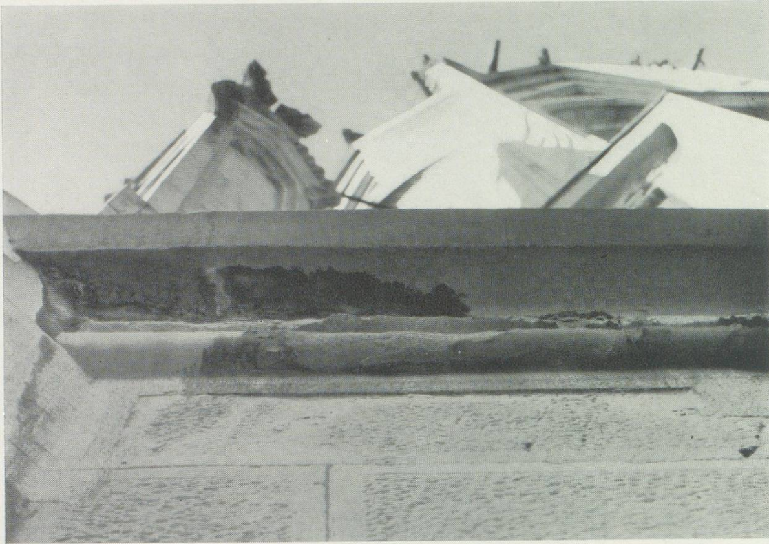
Verwitterung von unten, gefördert durch chemische Einflüsse des Stadtklimas
