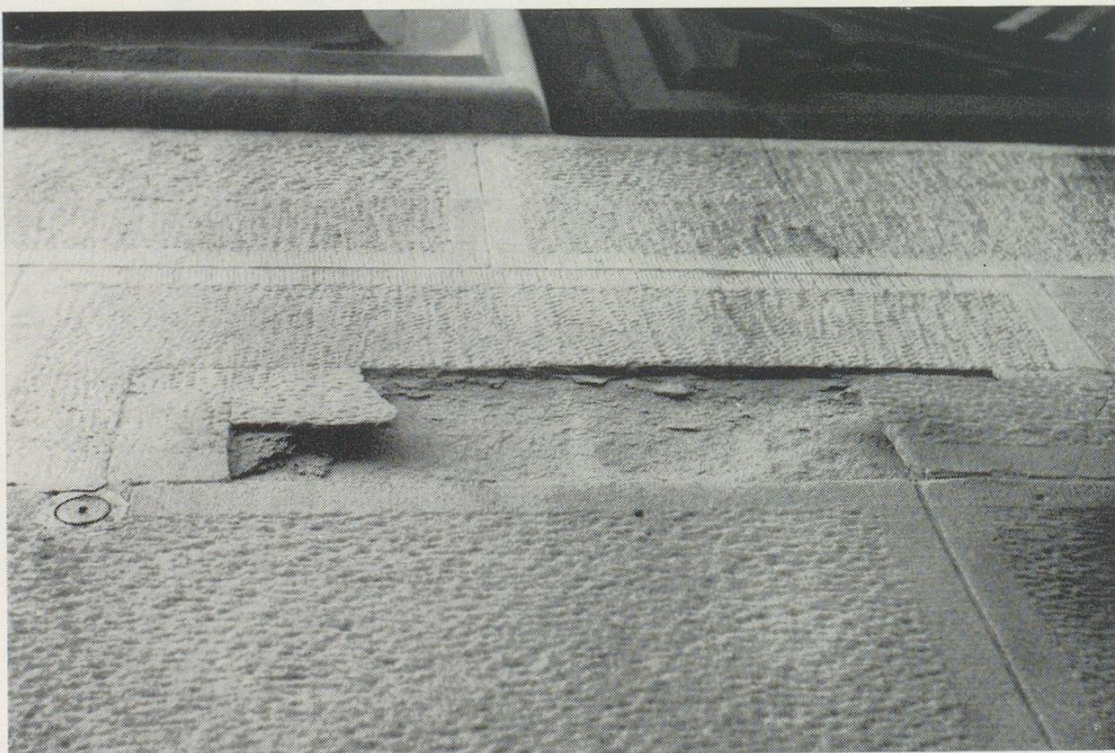
Abschälung an einem nicht steingerecht versetzten Werkstück
