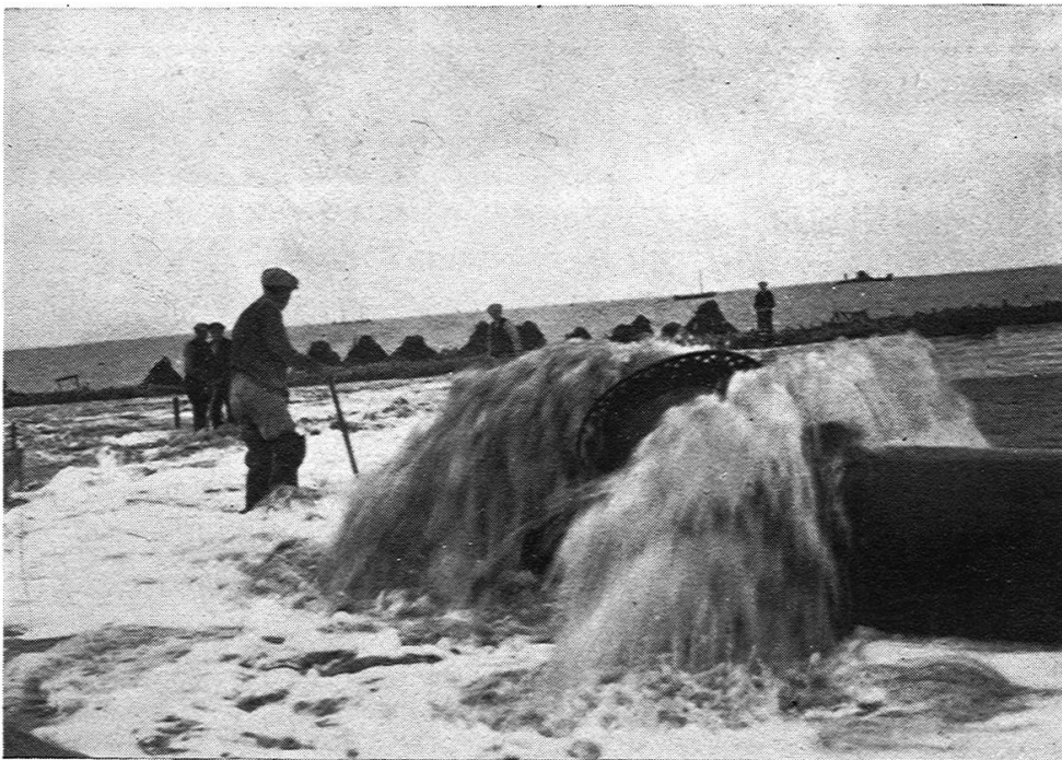
Fig. 7. Ende der Schwemmleitung für Sand. Länge 500 m, Röhrendurchmesser 60 cm. Aufnahmen von E. Leemann.
